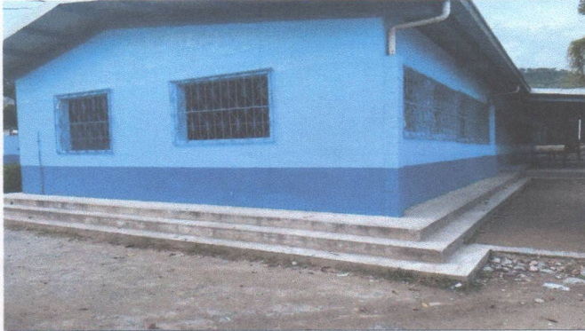
Foto 4: USO DE PINTURA EN AULAS AFECTADAS POR DESPRENDIMIENTO DE CAPA DE PINTURA Y DELAMINACION.
